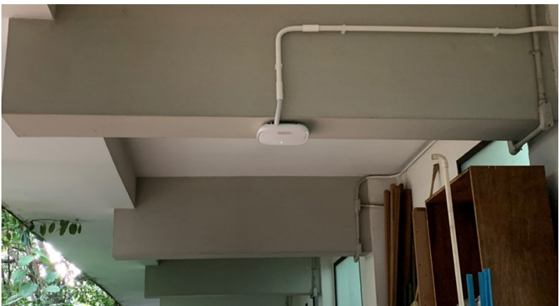
จุดติดตั้งเพิ่มเติม ณ อาคารจุฬาวิรัช ชั้น 1
