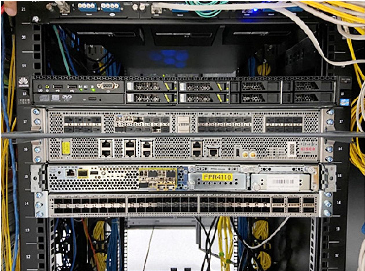
อุปกรณ์ Router ณ วันที่ติดตั้งที่ห้อง Data Center อาคารจามจุรี 9 ชั้น 4
