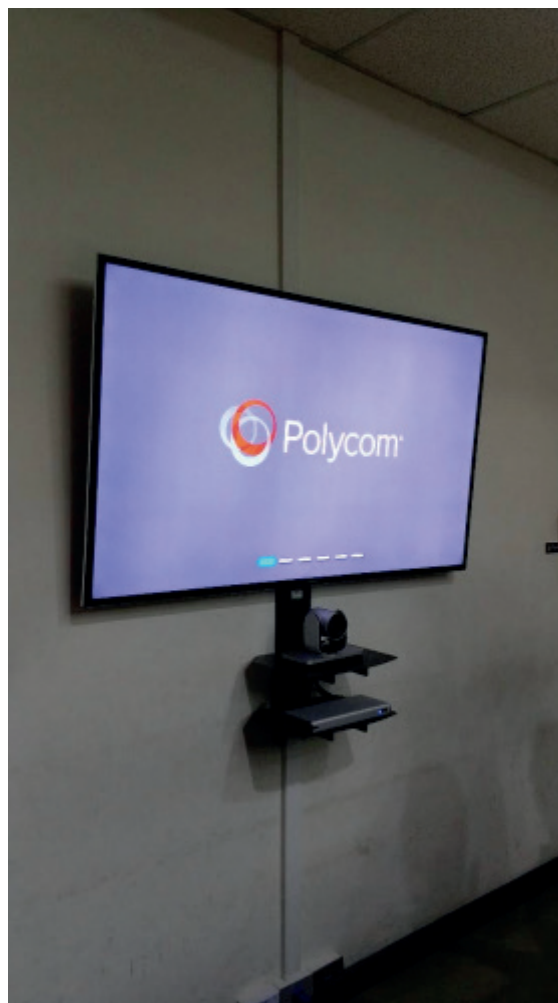
ภาพที่ 3.5 ระบบประชุม Polycom ห้อง 203 อาคารจามจุรี 3 ชั้น 2
