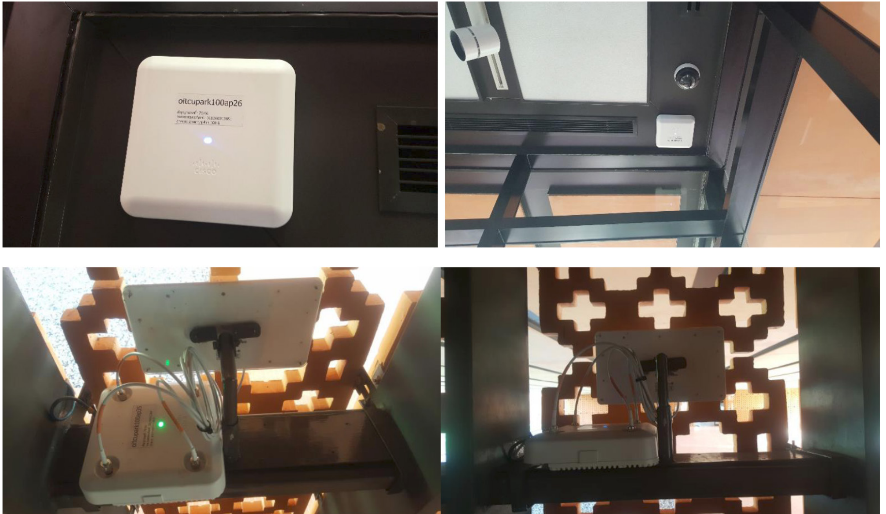
ภาพที่ 2.13 access point ที่ติดตั้งภายในอาคารของอุทยาน ๑๐๐ ปี จุฬาลงกรณ์มหาวิทยาลัย
