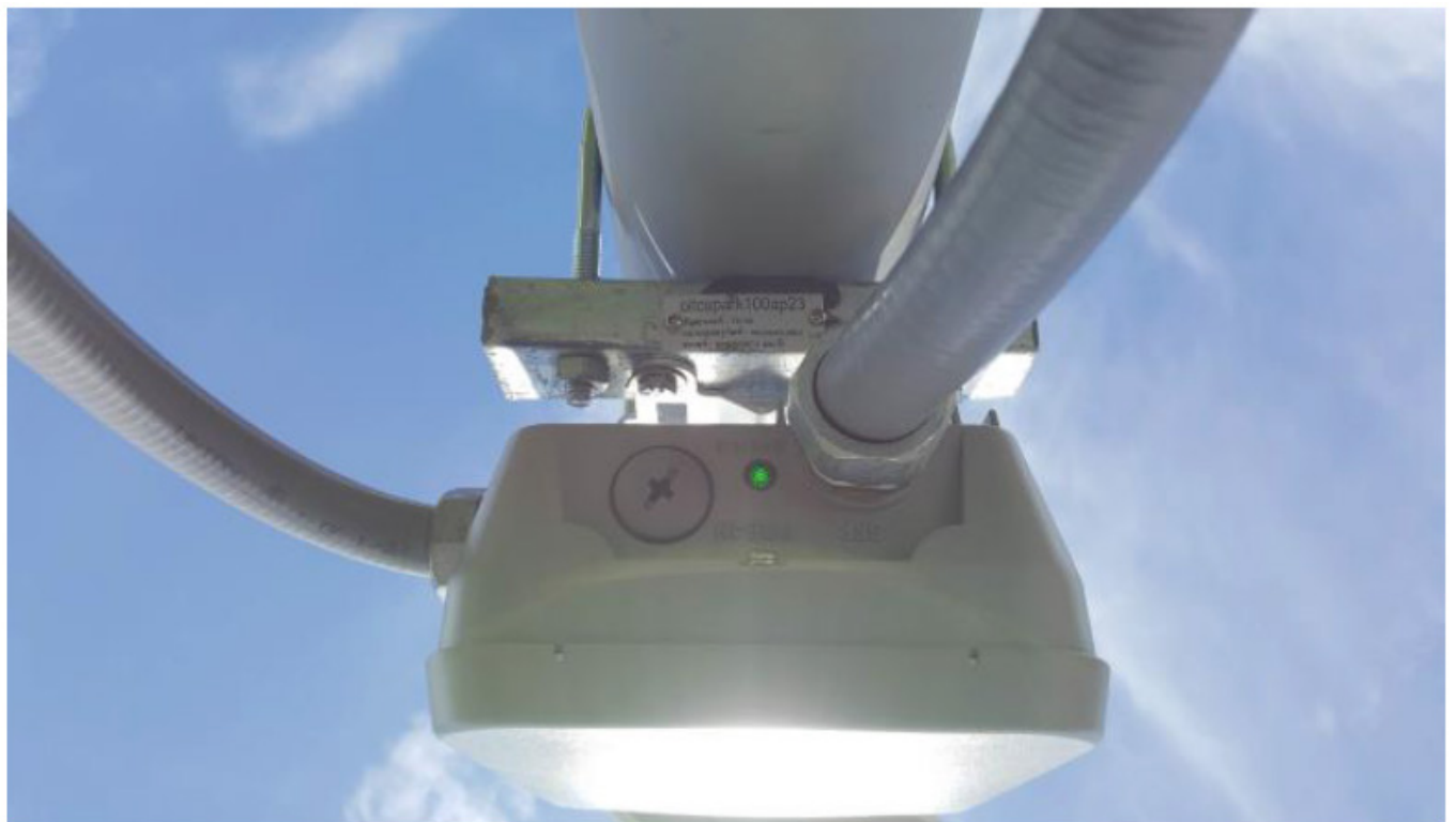
ภาพที่ 2.12 access point ที่ติดตั้งภายนอกอาคารของอุทยาน ๑๐๐ ปี จุฬาลงกรณ์มหาวิทยาลัย
