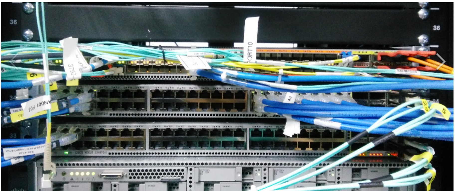
ภาพที่ 2.8 อุปกรณ์กระจายสัญญาณภายในห้อง Data Center ณ อาคารมหิตลาธิเบศร
