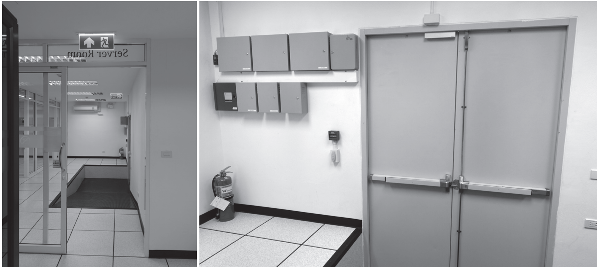
ภาพที่ 17 ห้อง Data Center ณ อาคารมหิตลาธิเบศร
